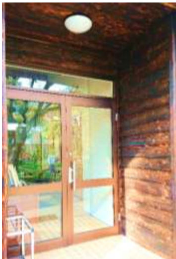
消防法に基づいた外開きの玄関扉
